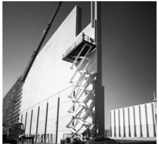
Sicherheit durch Hebel Brandwände im IKEA Zentrallager Salzgitter.
